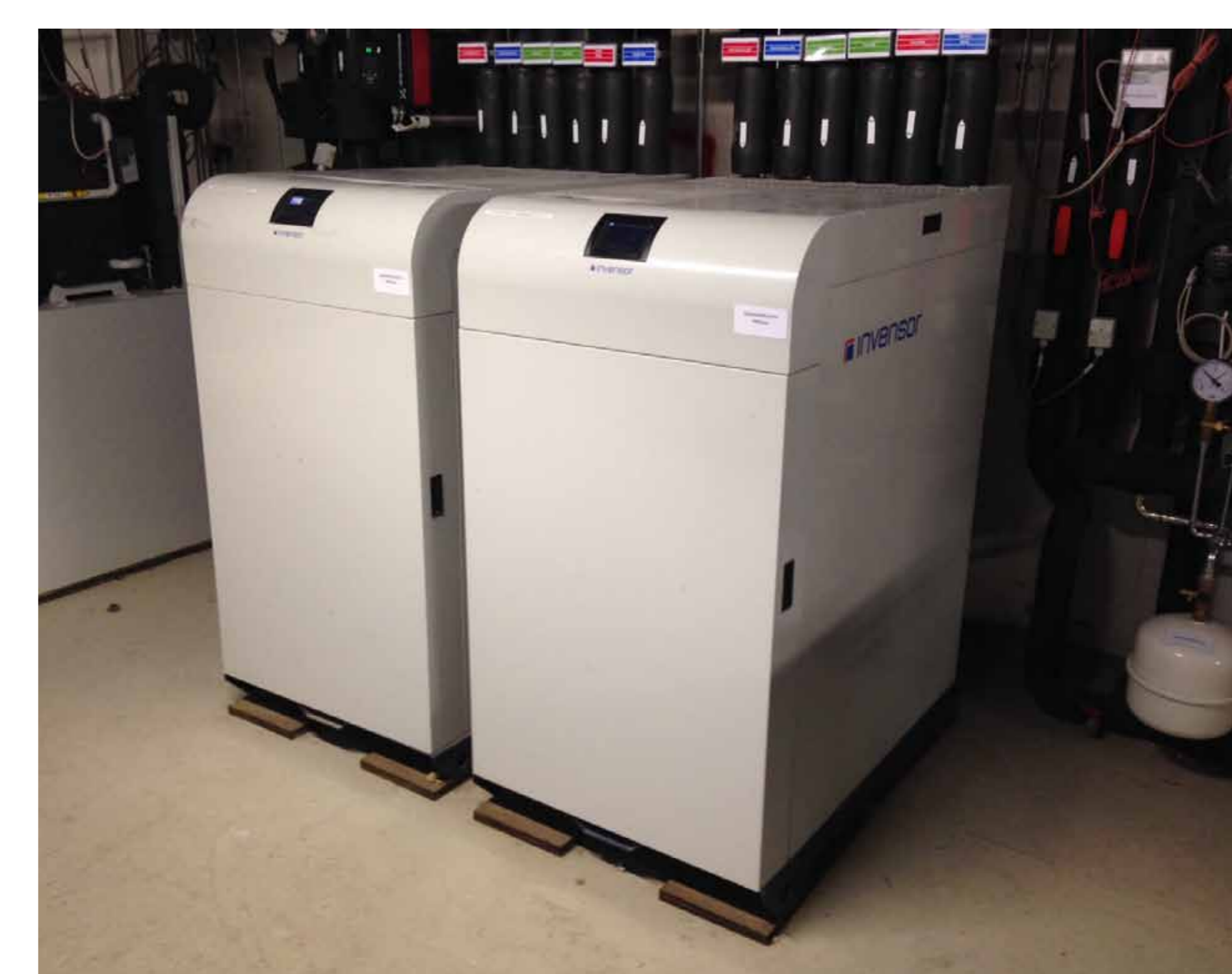
Wärmepumpen der Abwasserwärmenutzung
